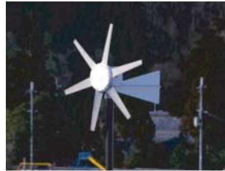
新庄小学校風力発電施設(八木町)
