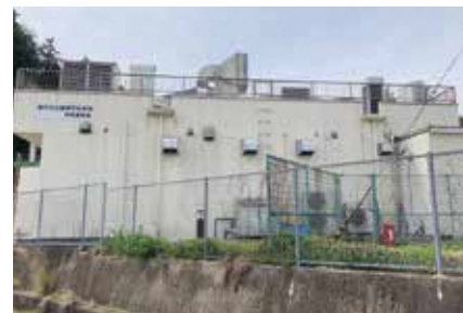
老朽化した園部学校給食センター
