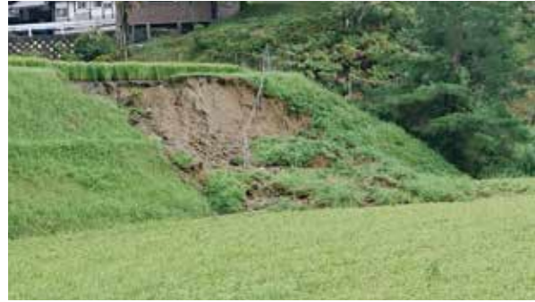
災害で崩落した法面
