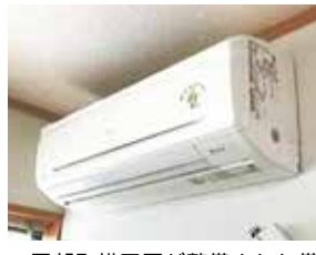
▲園部町横田区が整備された備品
