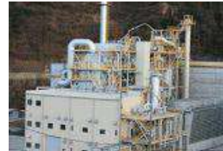
間伐材等を原料とする木質バイオマス発電施設
