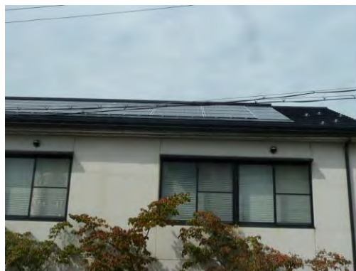
太陽光発電設備
